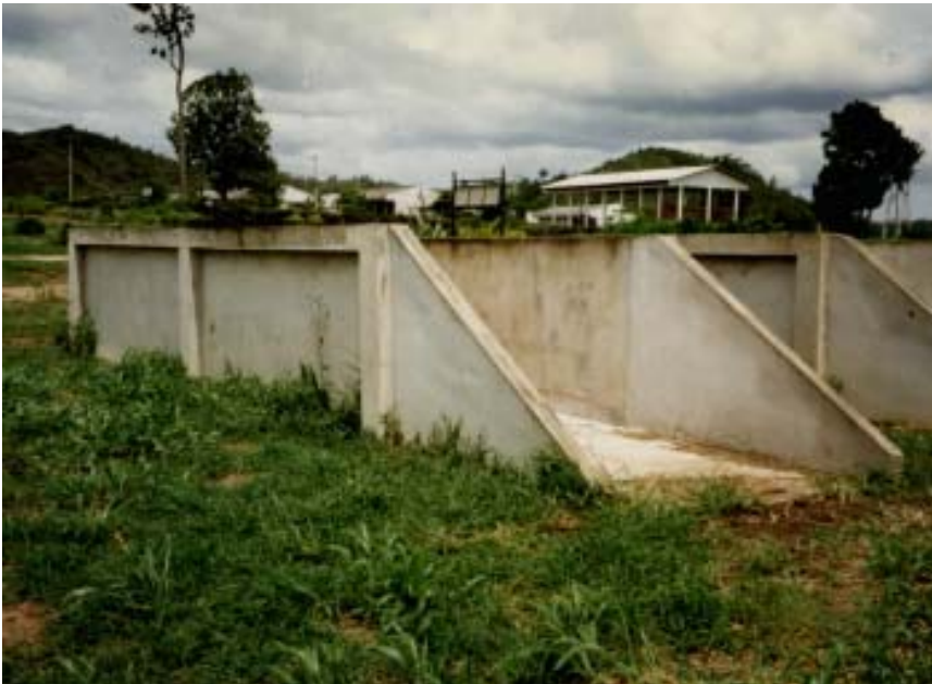
หลุมหมักแบบกำแพงคอนกรีต
